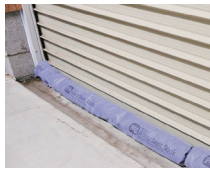
シャッター下からの 雨水の侵入対策
