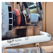
油漏れをキャッチ!
